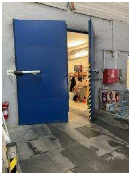
Obrázek 6 - požární dveře při zkoušce otevírání
