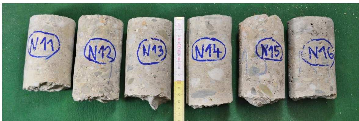
Obr. 3: Zkušební vzorky N 11 až N 16 odebrané ze stropní desky nad 1. NP objektu.
